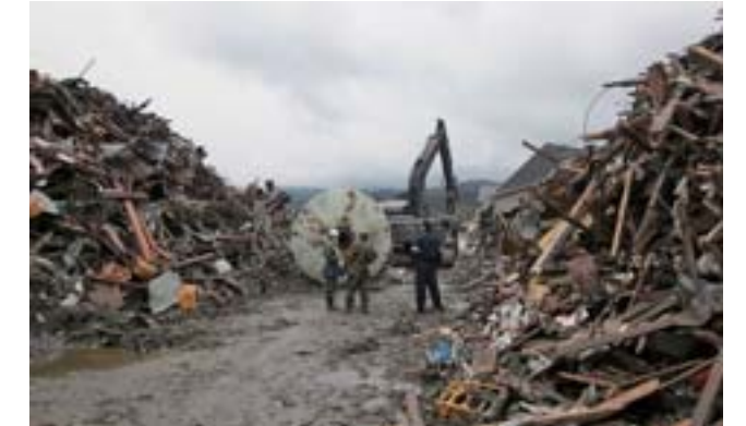
緊急輸送道路の確保作業（道路啓開） (写真提供：東北地方整備局)
